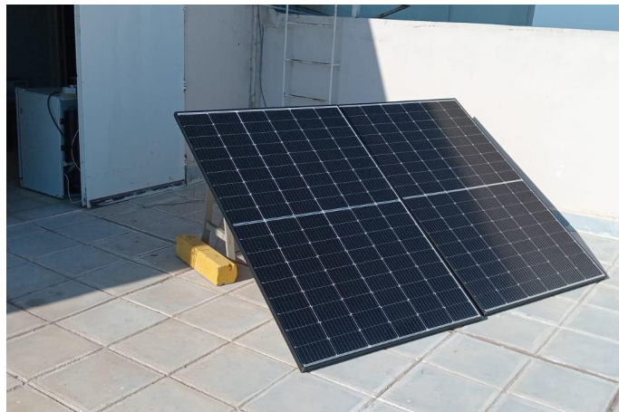
Figura 2. Vista de los paneles solares
